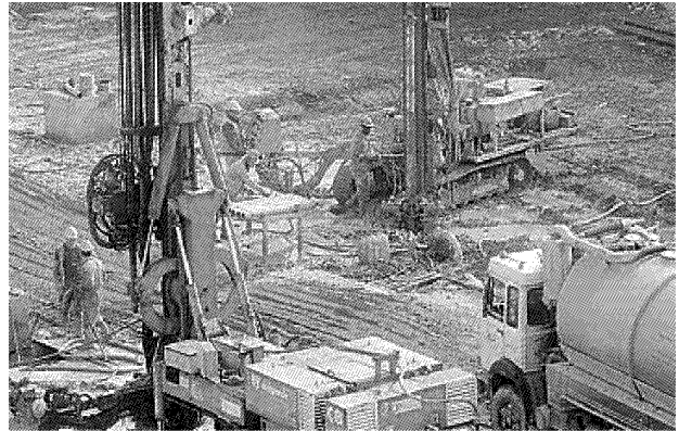
CANTIERI TAV Appena aperti da Firenze arriveranno treni con inerti di scavo: ma torna l'allarme sul materiale da rifiuti speciali
